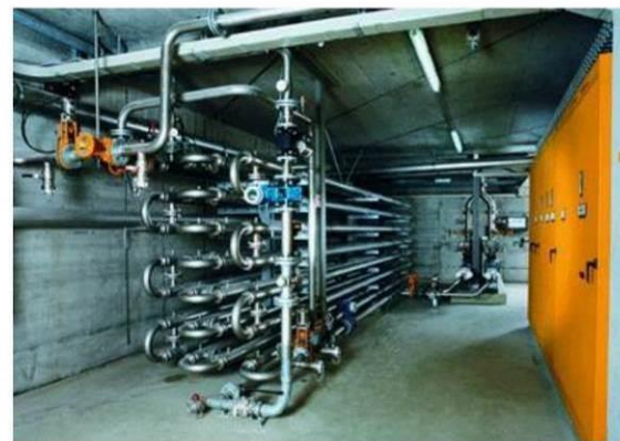
Figure 25 : Echangeur tubulaire en sortie de STEP (Lyonnaise des Eaux, ISTINOX, ANTEA)
